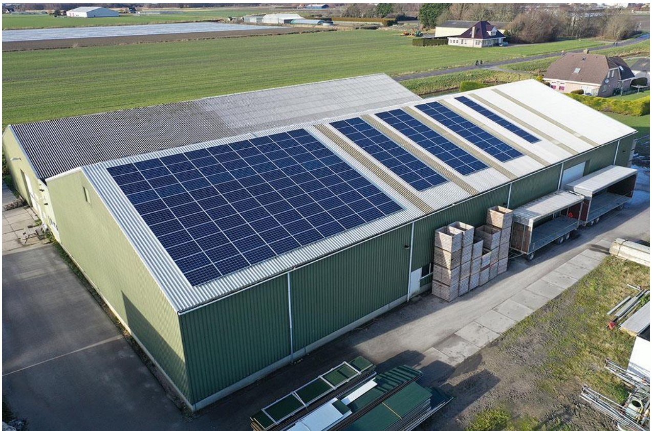
Photovoltaik auf einer Gewerbehalle
